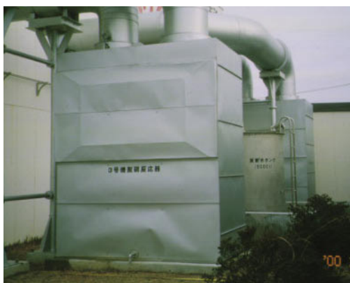
ディーゼル発電設備用排ガス脱硝装置
