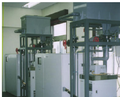
滅菌設備制御システム
