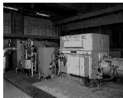
ごみ発電システム
