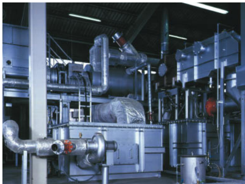
乾留形廃棄物処理システム
