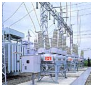
真空遮断器 (VCB)
