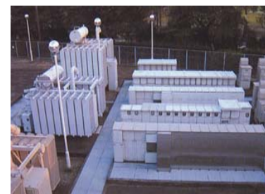
民間工場 (受変電設備)
