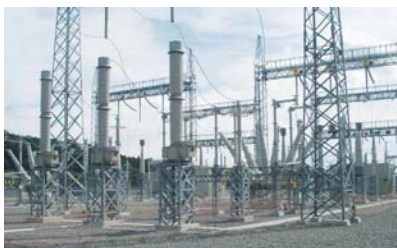
電鉄用変電設備
