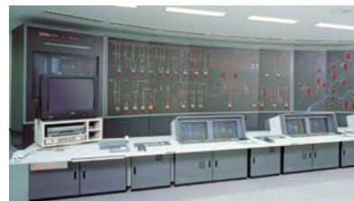
発・変電所集中 監視制御システム
