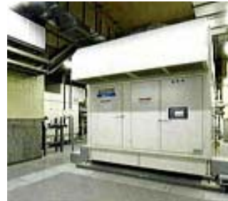
ガスエンジン コージェネレーション 設備(CGS)
