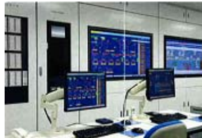
電力監視制御設備
