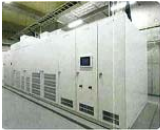
NAS電池設備
