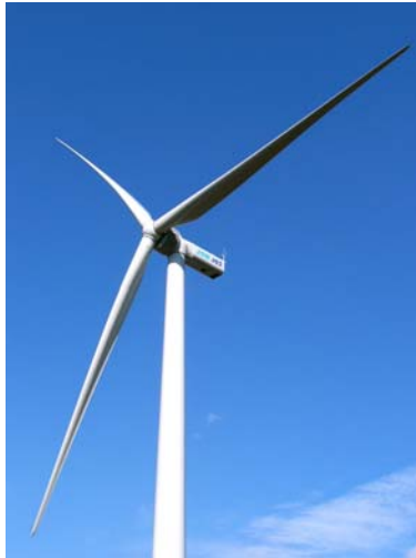
日本製鋼所様風力発電システム
