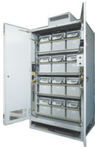
電鉄用回生電力貯蔵装置 キャパポスト
