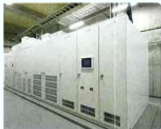
NAS電池設備
