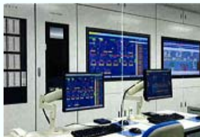
電力監視制御設備
