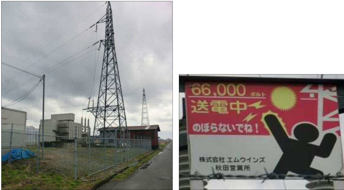
図 2.2.6-6 既設変電設備
