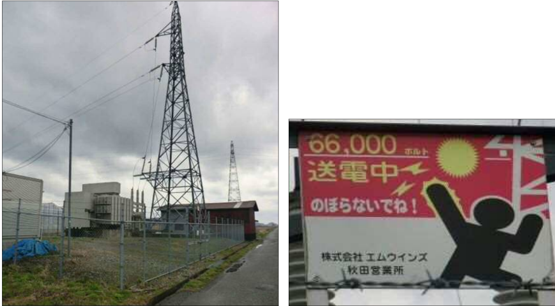
図 2.2.6-6 既設変電設備
