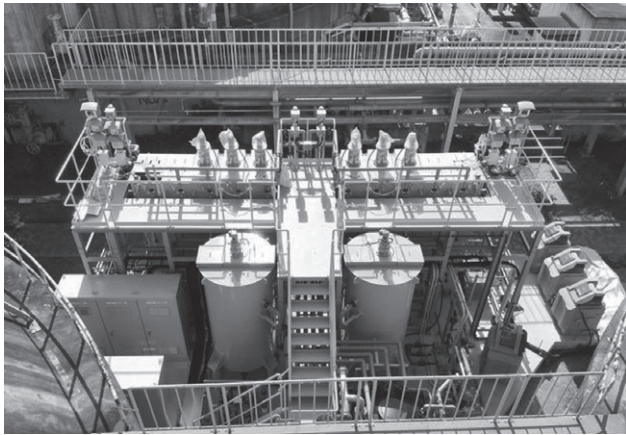
第5図 パイロット試験装置
