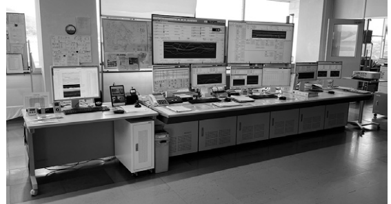
第 1 図 中央監視装置
