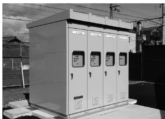
第5図 山端変電所 GIS
