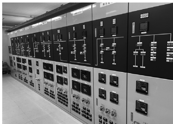
第3図 浜松町変電所 変電設備
