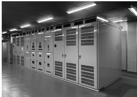
第1図 芝浦ふ頭駅変電所 き電設備
