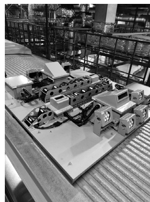
第8図 3号車 電車線設備モニタリング装置
