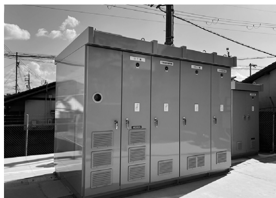
第4図 西ノ庄変電所 高圧盤
