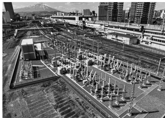
第6図 盛岡変電所 変電設備
