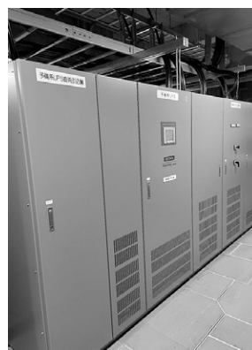
第12図 無停電電源装置
