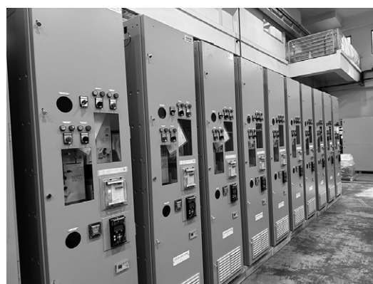
第5図 24kV C-GIS (複母線タイプ)
