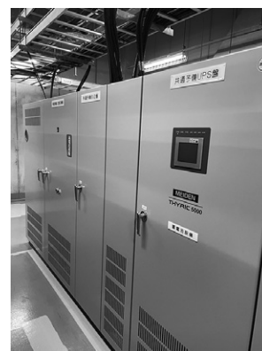
第11図 無停電電源装置
