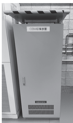
奥沢変電所納入CBM収集装置
