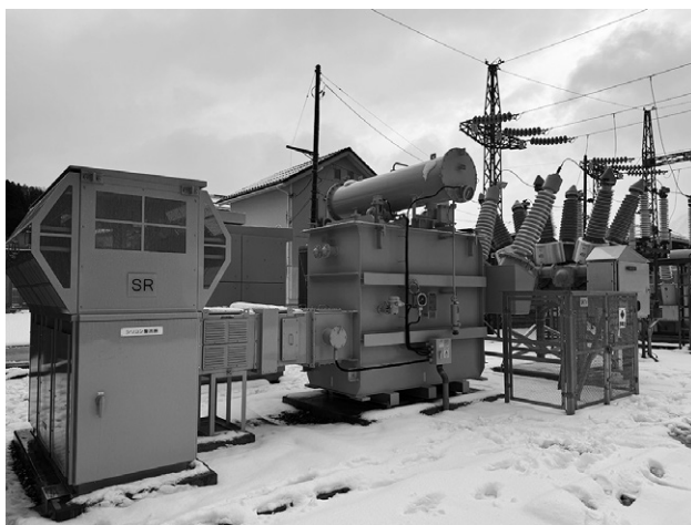
第4図 直流整流設備
