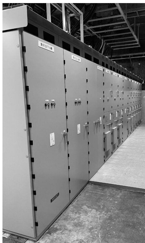
第5図 直流き電設備
