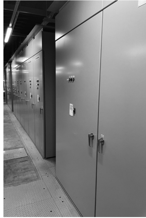
第3図 84kV GIS
