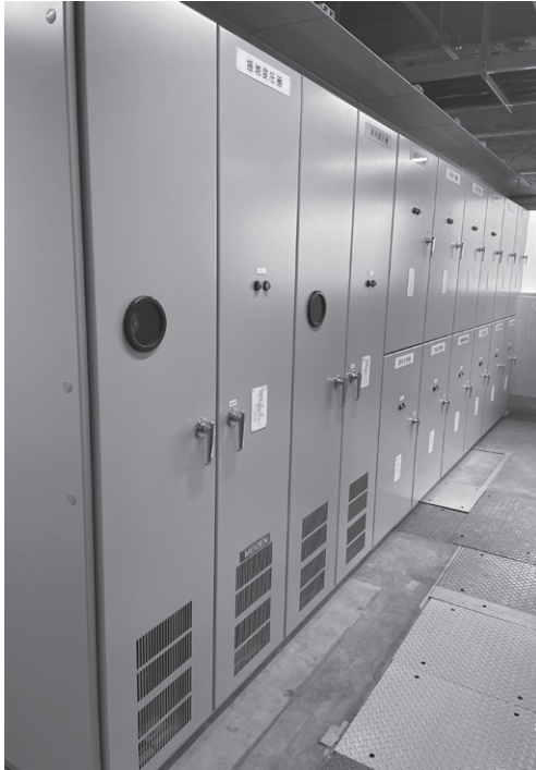
第6図 高圧配電設備
