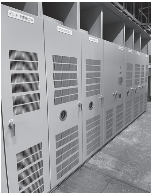
第7図 回生電力変換設備
