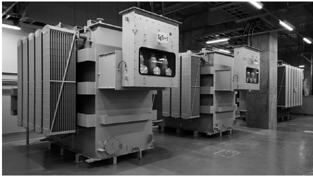
第7図 配電用変圧器（新横浜変電所）
