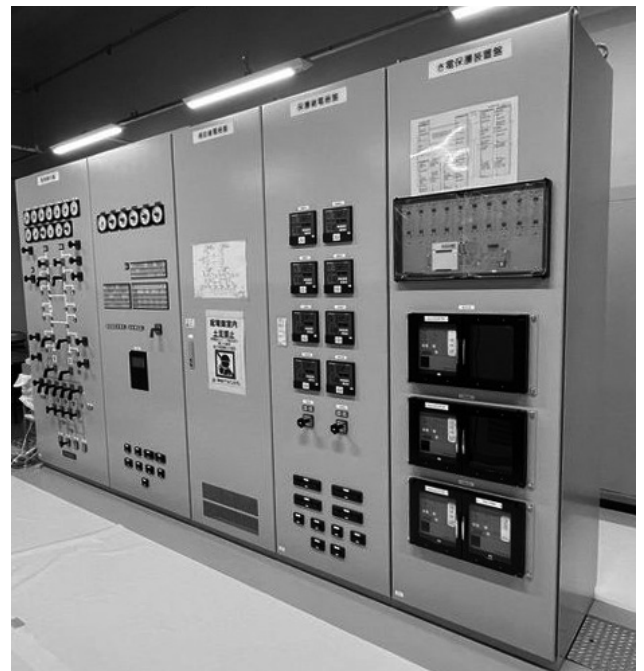
第9図 監視制御盤（新羽沢変電所）
