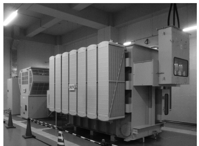
第 3 図 整流器用変圧器とシリコン整流器 (新羽沢変電所)
