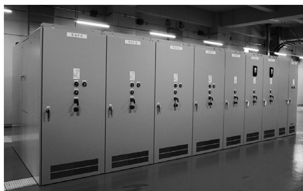
第5図 直流き電盤（新羽沢変電所）
