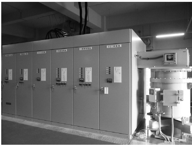
第 1 図 C-GIS (新羽沢変電所)
