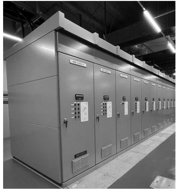
第 2 図 C-GIS (新横浜変電所)
