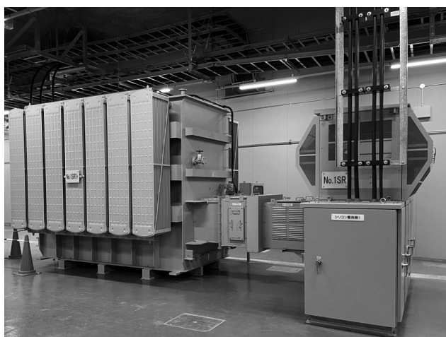
第4図 整流器用変圧器とシリコン整流器（新横浜変電所）
