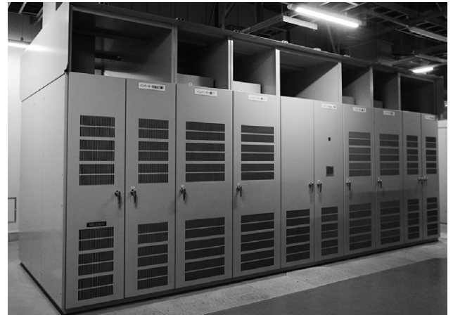
第8図 回生インバータ（新横浜変電所）
