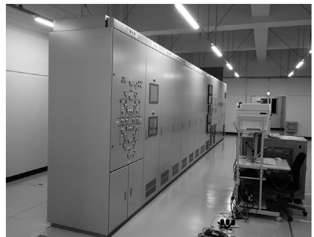
第8図 電鉄用配電盤
