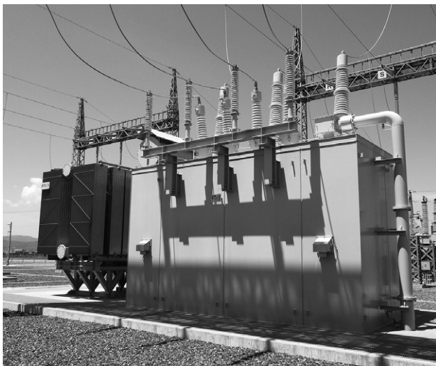
第 4 図 き電用変圧器
