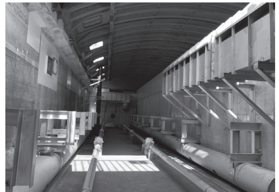
第5図 水張り前の高効率最初沈殿池
