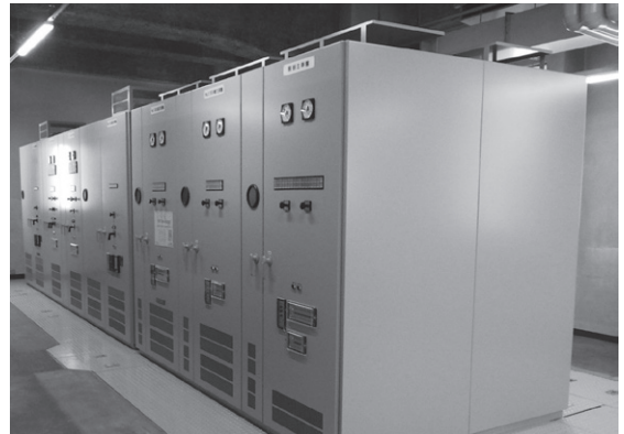
第1図 受変電設備
