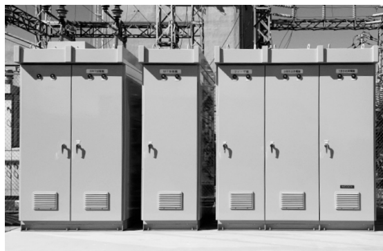
第2図 6.6kV受電設備・切替設備
