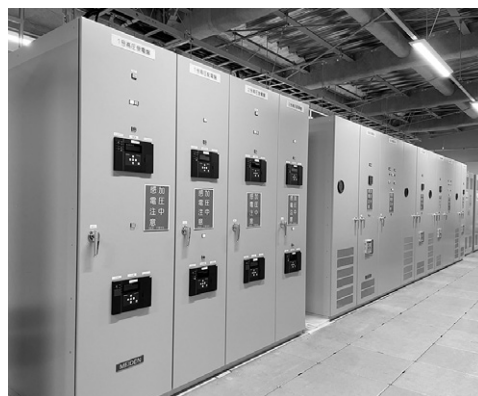
第3図 高圧配電設備
