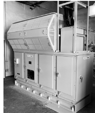
第4図 整流器設備
