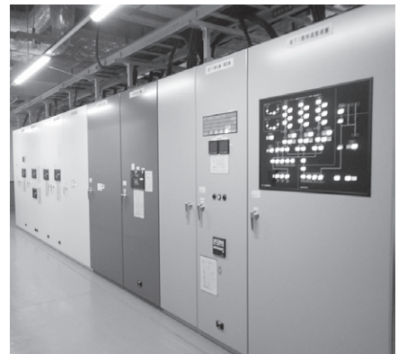
第2図 特高受変電設備
