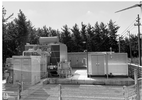
第4図 特高受変電設備
