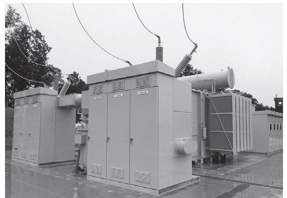
第3図 77kV特高受変電設備
