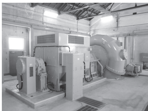
旭発電所更新設備
