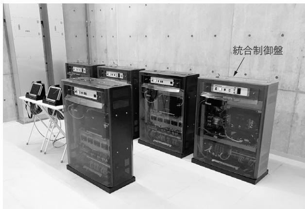
第11図 統合制御盤
