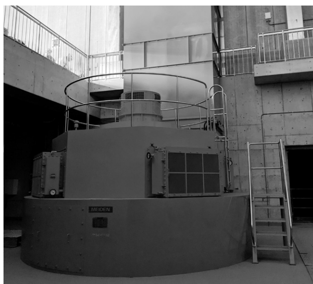
第13図 発電機の現地完成状態
