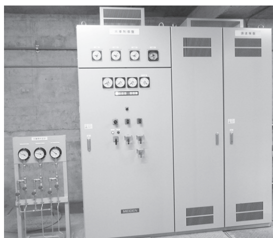
第4図 水車制御盤及び調速機制御盤
