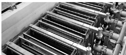
第11図 サウジアラビア浄水処理施設 セラミック平膜ユニット
