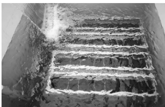
第8図 中国浄水処理施設 セラミック平膜ユニット
