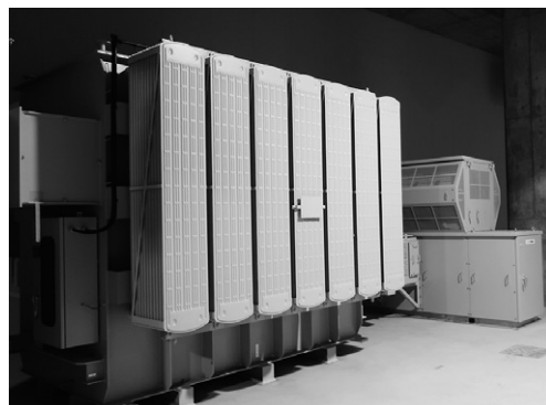
第1図 新横浜変電所 整流器用トランスとシリコン整流器
