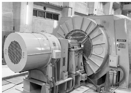
第 8 図 水力発電設備
