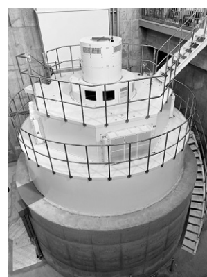
第 7 図 水力発電設備
