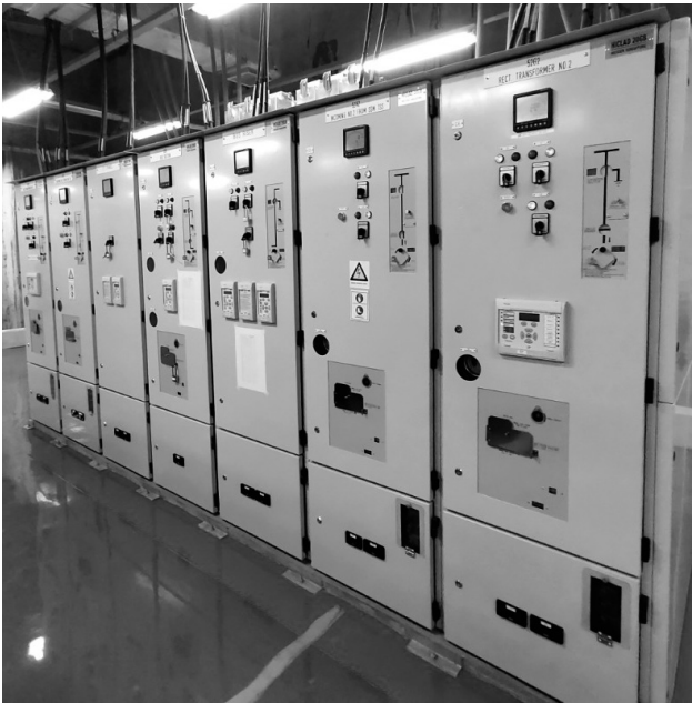
第 6 図 20kV GIS
