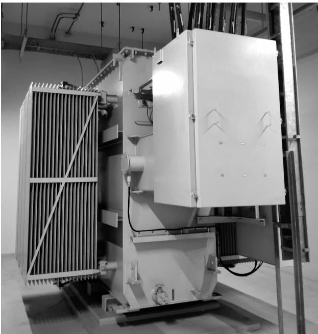
第 7 図 整流器用変圧器
