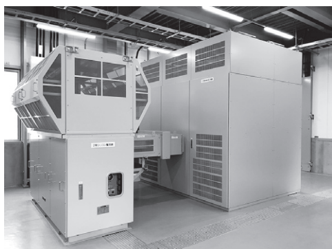
整流器用変圧器と整流器のバスダクト接続の様子
