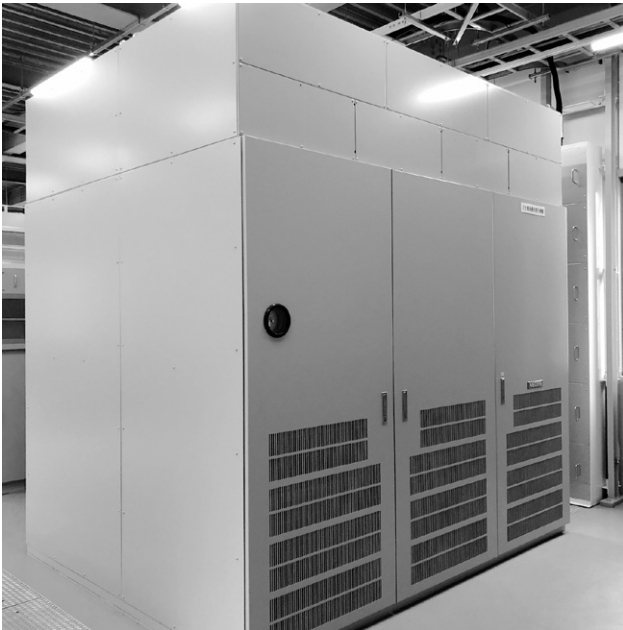
第4図 整流器用変圧器
