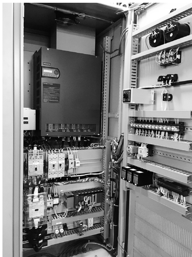
第3図 インバータ盤の内部
