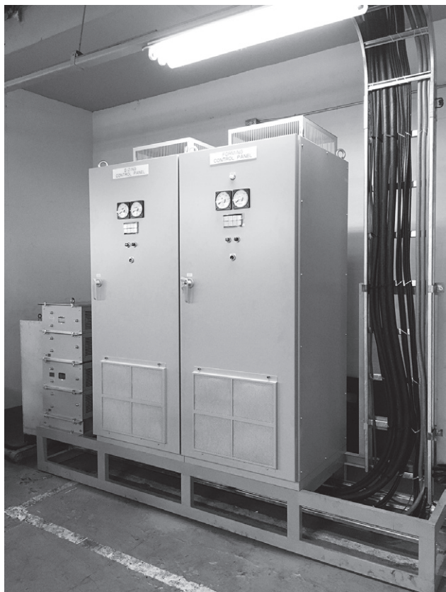
第4図 インバータ盤の電気室設置状況
