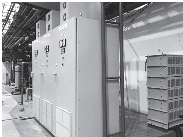
第5図 インバータ盤の工場内設置状況
