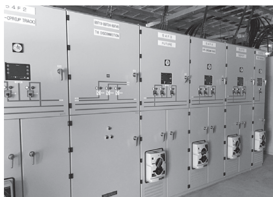
第5図 DC1500V直流配電盤
