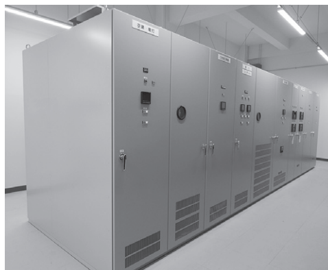
第2図 高圧配電設備
