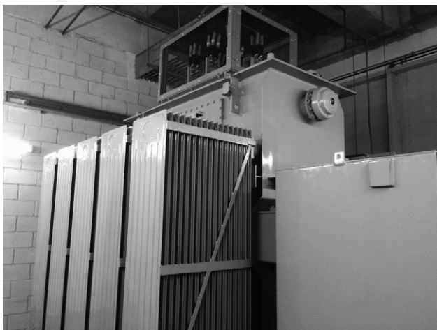
第 2 図 3300kVA 整流器用変圧器
