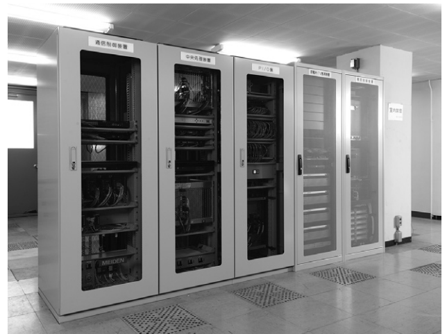
第 5 図 機器室設置の各盤
