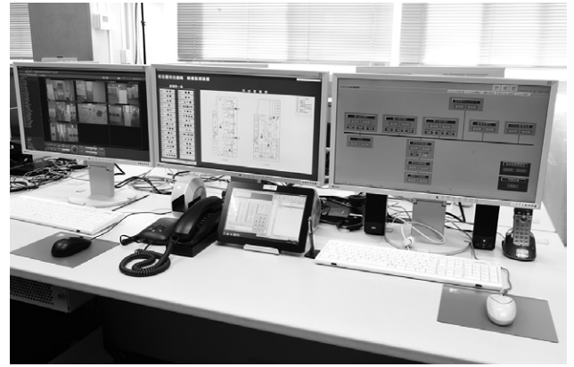
第 4 図 映像監視装置 (左と中央) とシステム監視装置 (右)
