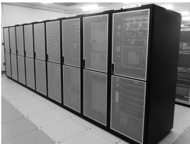
第4図 電力管理サーバ盤
