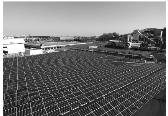
第2図 1MW太陽光発電設備
