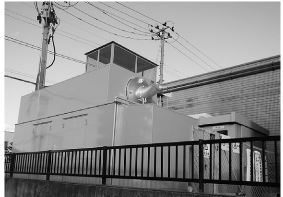
第10図 環境対策型非常用ディーゼル発電装置
