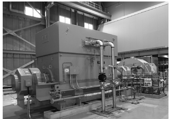
第16図 24,445kVA同期発電機
