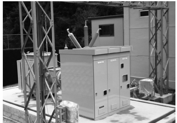
第5図 66kV特高受変電設備
