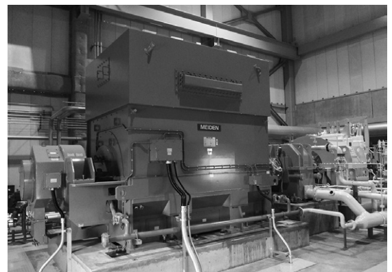
第15図 18,556kVA同期発電機
