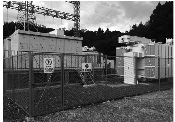
第4図 高圧配電盤（左）と特高変圧器（右）
