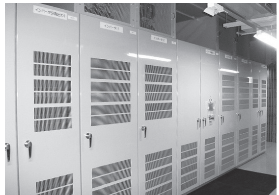
第5図 変電設備
