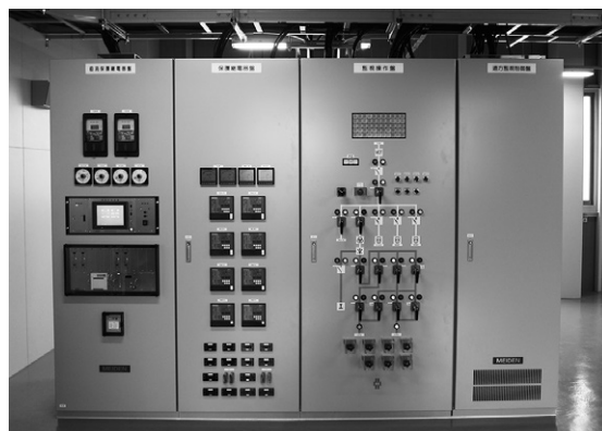
第3図 受変電設備
