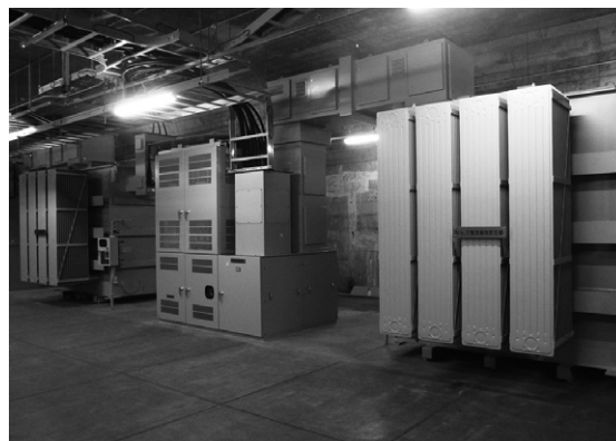
第1図 直流整流設備
