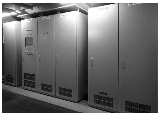
第2図 排水ポンプ設備P2
