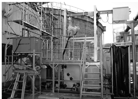
第3図 消化汚泥膜ろ過濃縮設備
