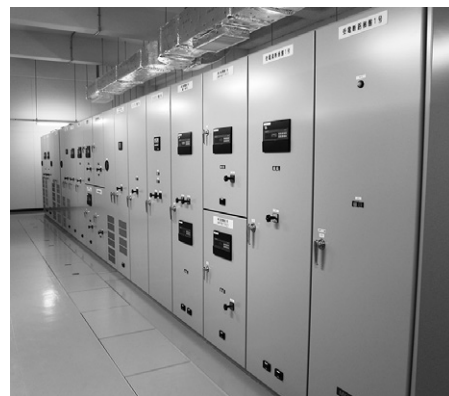
第1図 新函館駅配電所 高圧配電盤
