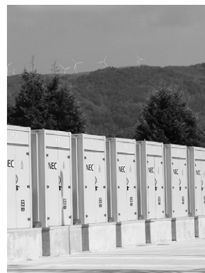
第32図 大容量リチウムイオン蓄電池システム
