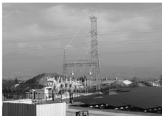
第26図 やまなしメガソーラー（韮崎）連系変電所全景
