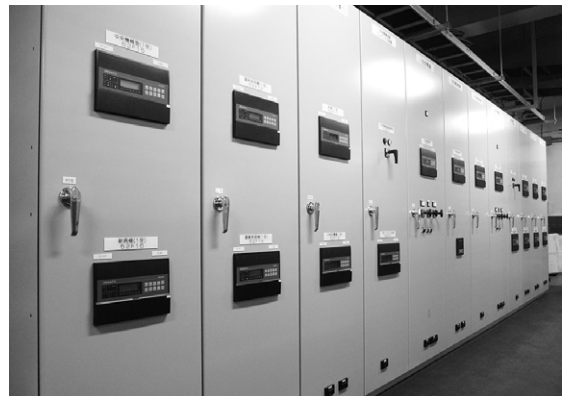
第19図 高圧配電盤
