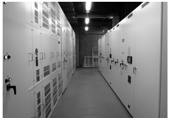
第20図 SNW受電設備
