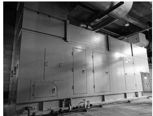
第7図 常用・非常用ディーゼルエンジン発電設備
