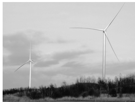
第22図 2000kW風力発電装置
