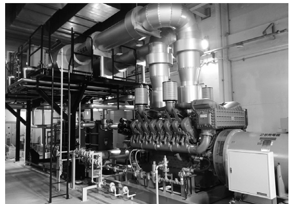
第8図 2号非常用ディーゼルエンジン発電設備
