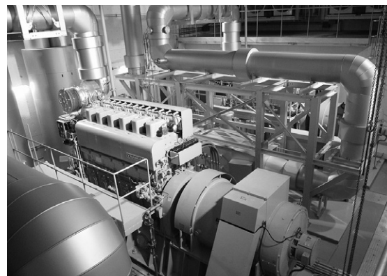
第6図 常用・非常用ディーゼル発電設備
