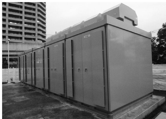
第28図 NAS電池用交直変換装置
