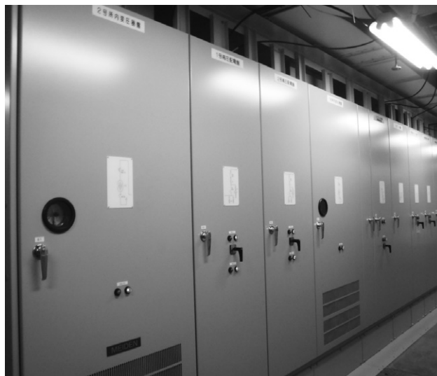
第3図 高圧配電設備
