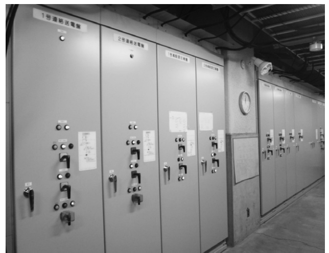
第 2 図 22kV 特高設備
