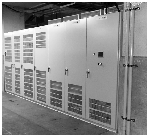
第4図 電力回生インバータ設備
