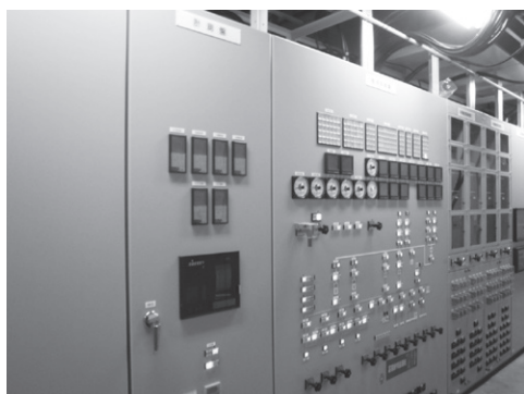
監視制御設備
