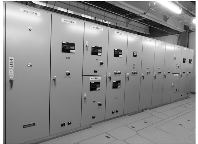
第14図 糸魚川DP 高圧配電盤
