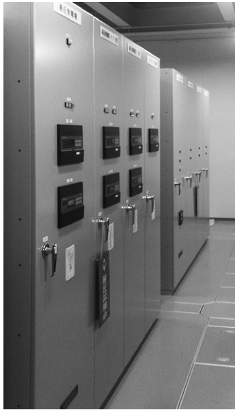
第13図 西笠原DP 高圧配電盤
