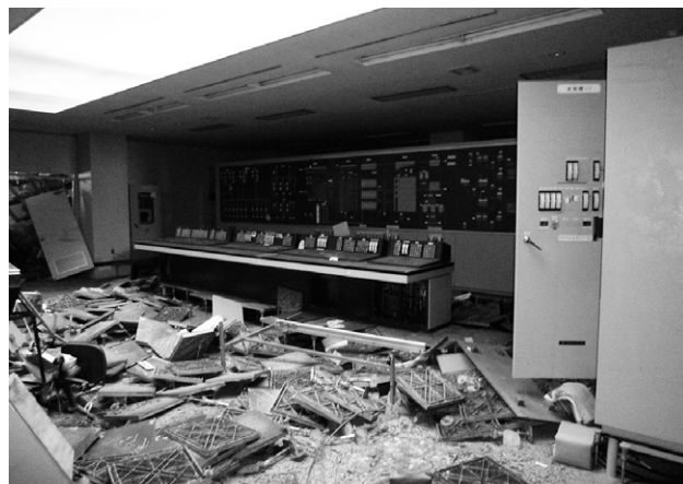
第4図 気仙沼終末処理場の管理本館監視室の被害状況
