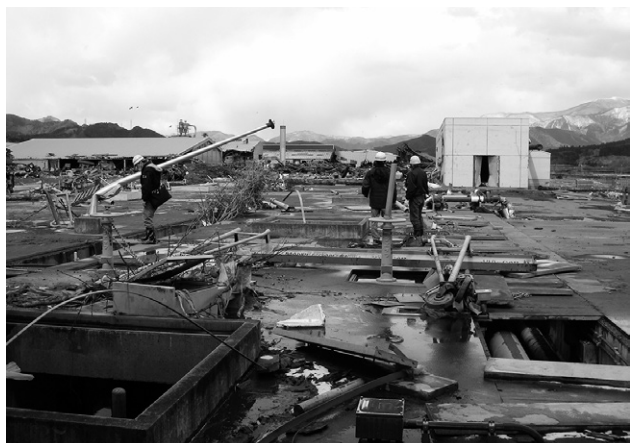
第3図 大船渡浄化センターの水処理施設上部の被害状況
