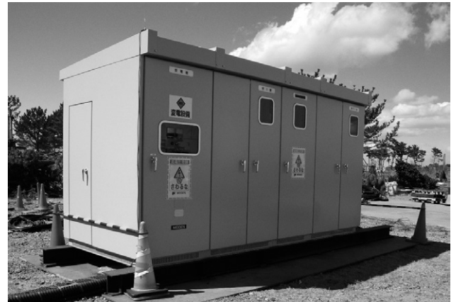
第1図 県南浄化センターの屋外仮設受変電設備
