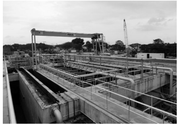
第9図 ジュロン工業排水再利用設備
