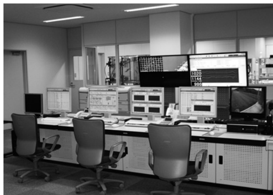
第1図 当別浄水場中央監視制御設備
