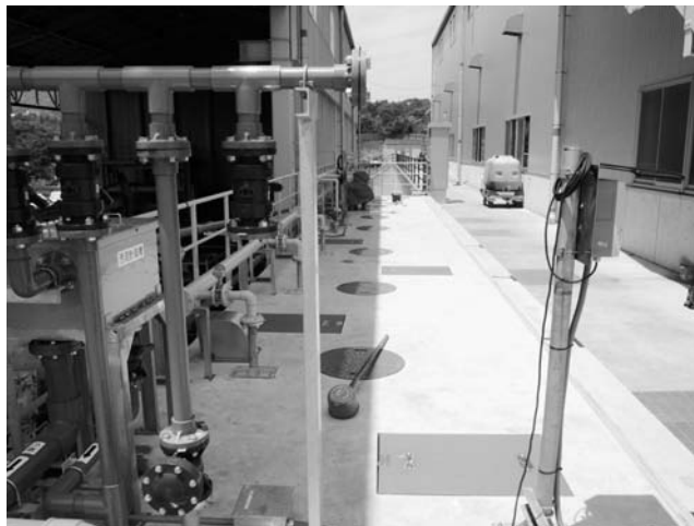
第11図 廃LLC処理設備
