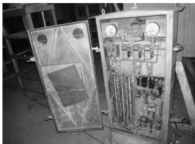
第2図 ガス遮断器の操作部 操作箱の内部には海水が浸入し漂流物が付着している。
