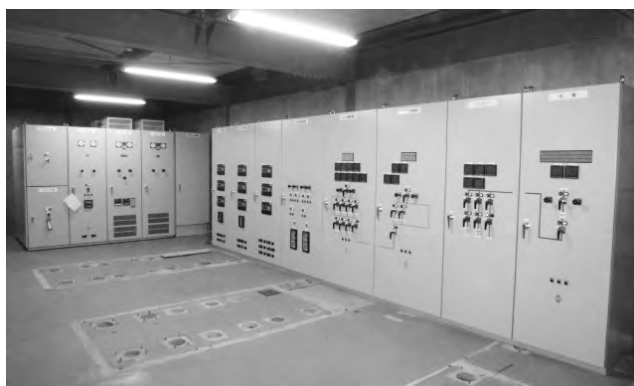
第8図 復旧した現場監視操作盤
