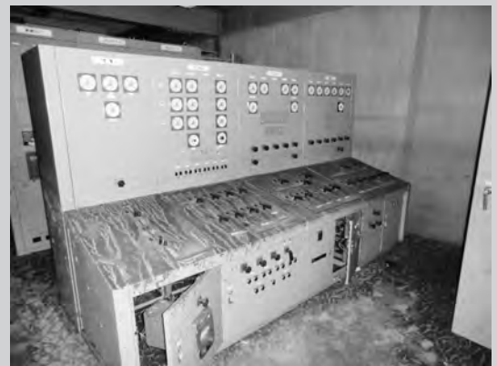
津波によって汚泥被災した監視制御盤
