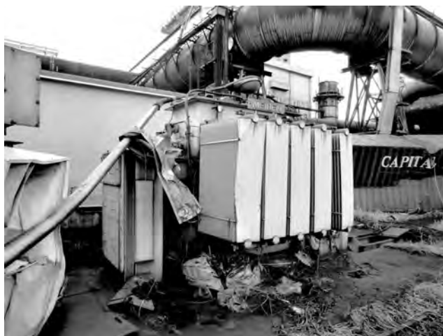
第6図 被災した変圧器 変圧器は漂流物の衝突で著しく破損しており、再使用が難しい状況であった。
