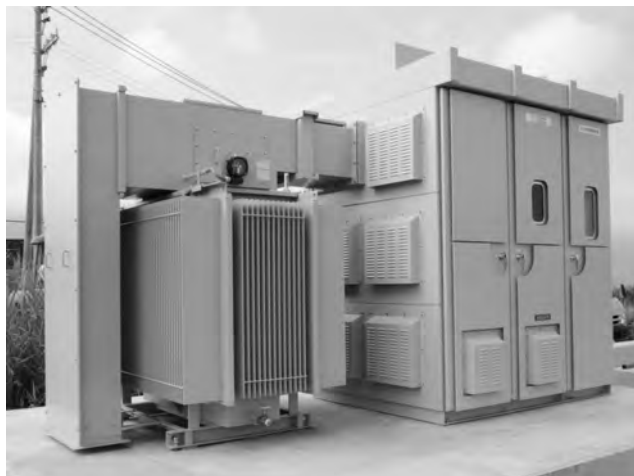
第3図 中間変電所
