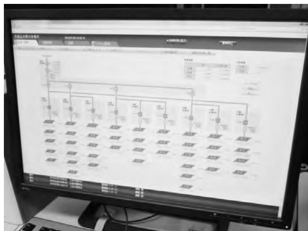
第5図 PV監視装置画面
