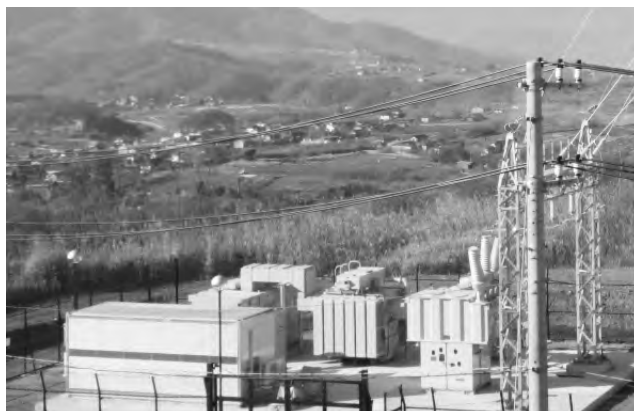
第4図 連系変電所
