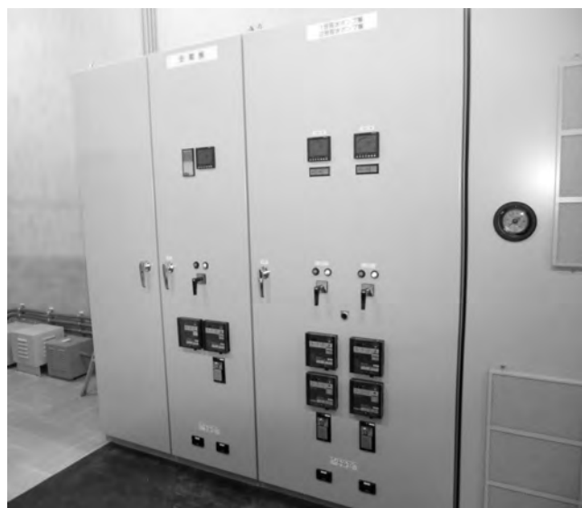
第2図 高圧受電盤 高圧受電盤の外観を示す。左が受電盤、右側がポンプ盤でポンプ2台分の遮断器を収納している。
