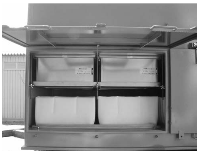
第11図 フィルタの取り付け状況 フィルタ点検扉をあけた状態を示す。上段は塩害防止フィルタ、下段はプレフィルタである。
