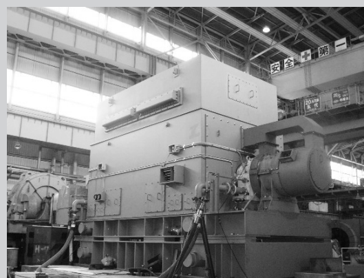
タービン発電機
