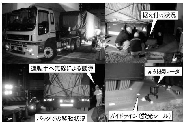
第12図 搬入据え付け状況 電源車を設置位置へ搬入据え付けしている状況を示す。
