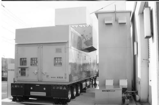
第1図 簡易設置形電源ユニット設備 簡易設置形電源ユニット設備の全景を示す。
