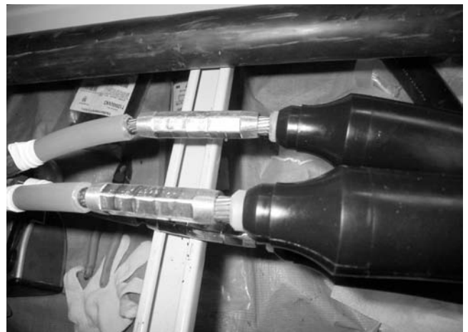
第8図 異形直線接続用圧縮スリーブ 今回使用した異形直線接続用圧縮スリーブの施工状況を示す。
