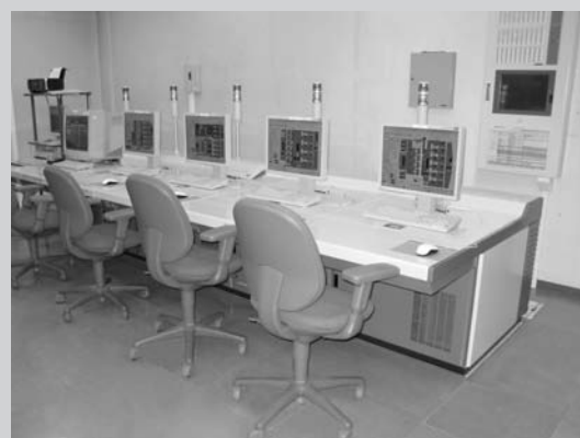
名城水処理センター遠方監視制御装置
