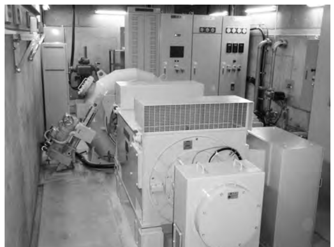
第6図 水車発電機
