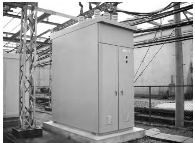
第17図 11kV特高配電盤
