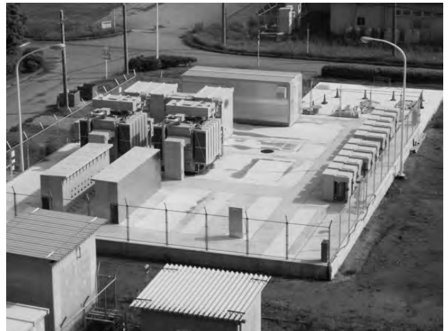
第19図 特高変電所
